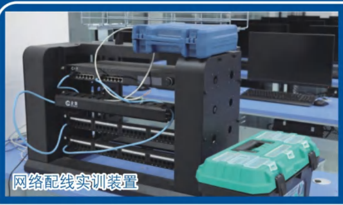
综合布线实训室
